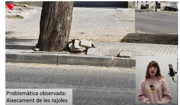
Imatge 24 Problemàtica observada de l'escocell 5 segons
