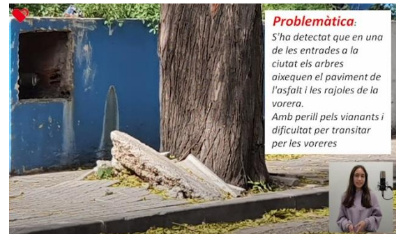
Imatge 12 Problemàtica 3 segons
